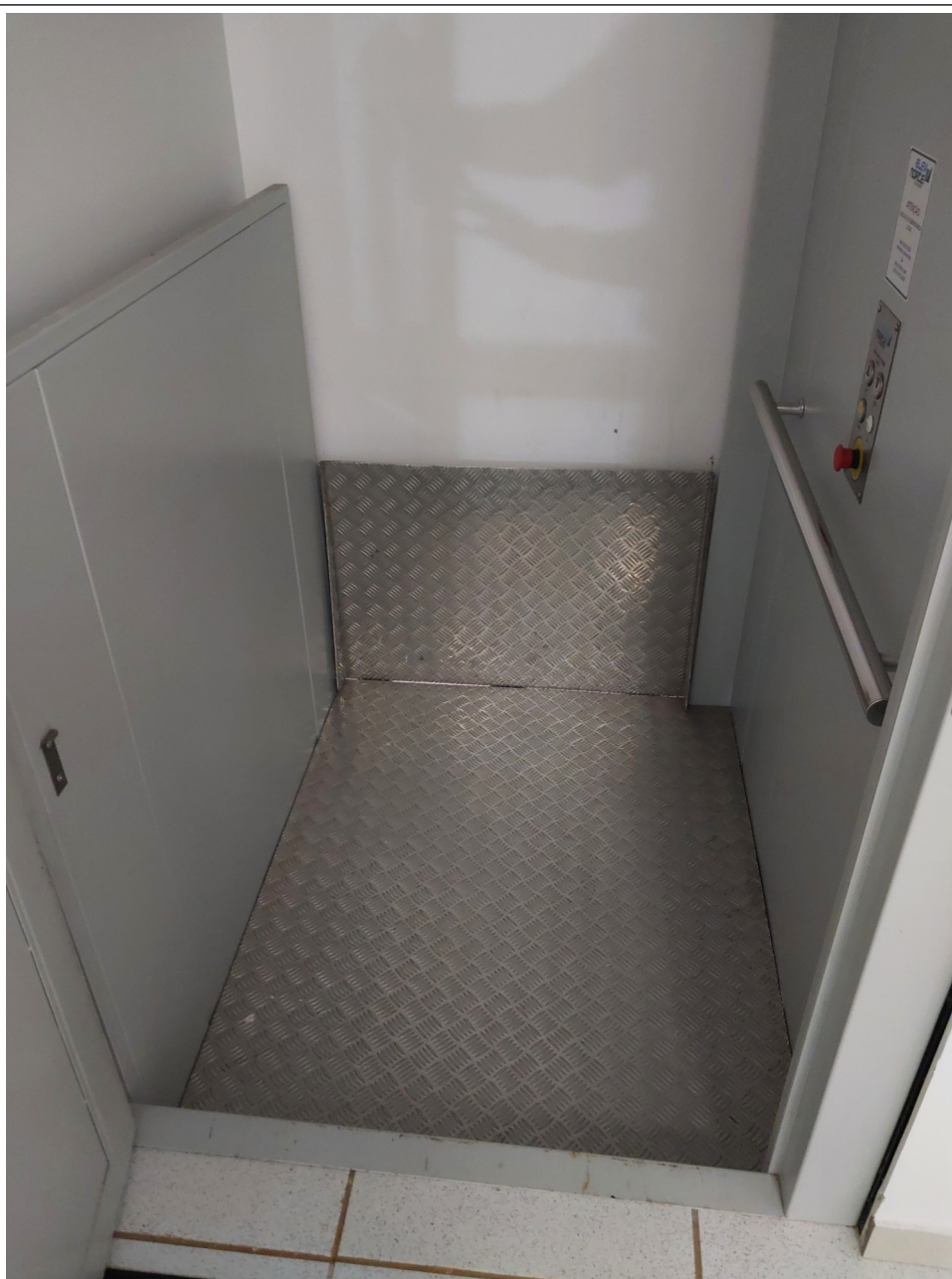
Fotografia nº 3 (Cabine Interna da Plataforma):
